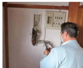
業者による火災報知器整備
